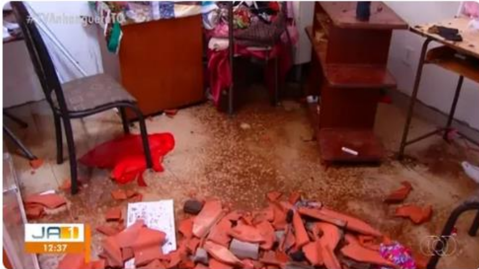
Telhado da casa cai e deixa moradores desabrigados em Palmas — Foto: Reprodução/TV Anhanguera
