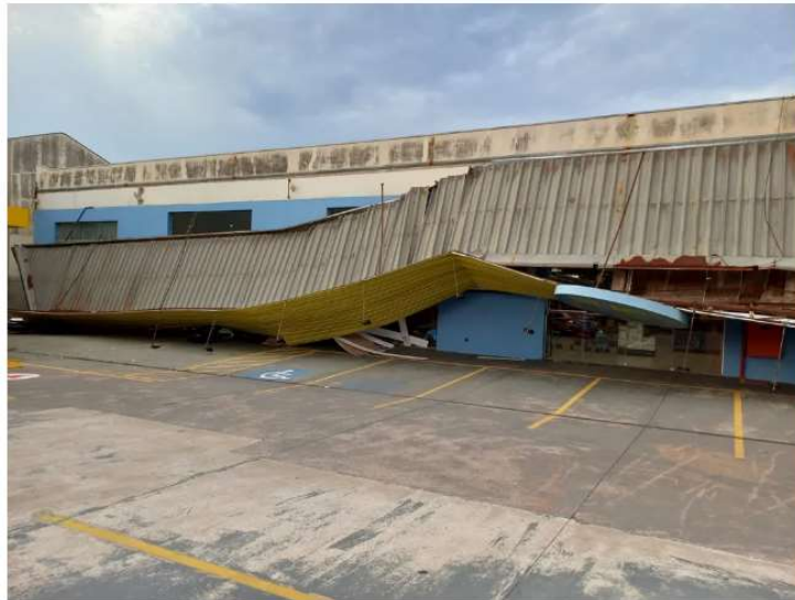
Parte da estrutura metálica de um estabelecimento ficou pendurada, na Avenida Manoel Goulart — Foto: Betto Lopes/TV Fronteira
