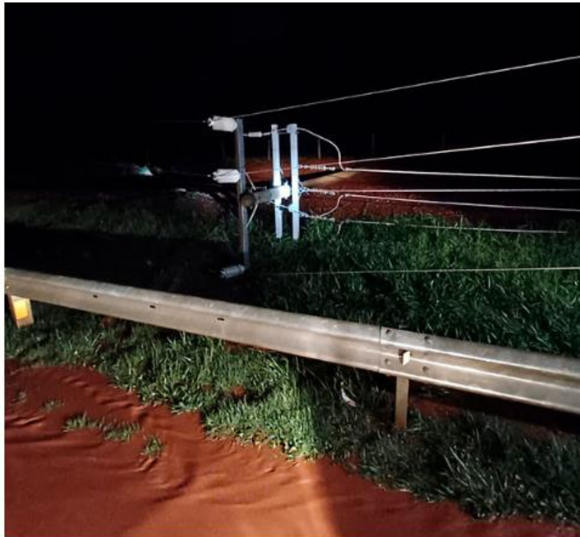
Poste de Energia caído após temporal em Florínea - Foto: Divulgação/Energisa
