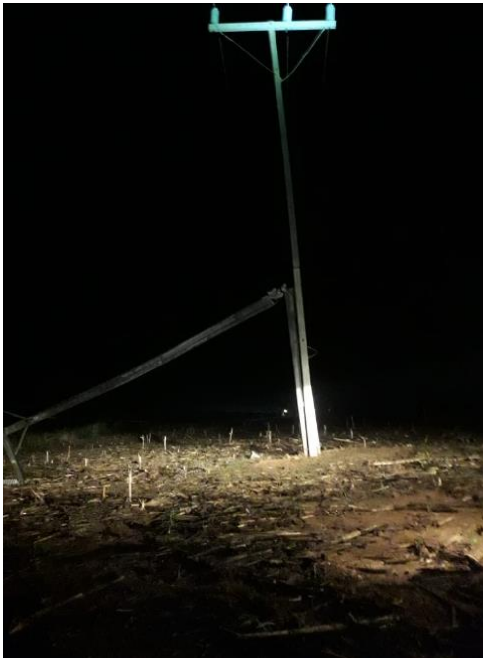
Figura 83 - Poste quebrado em Matupá no alimentador 093011. Foto tirada em 01/10/2022.
