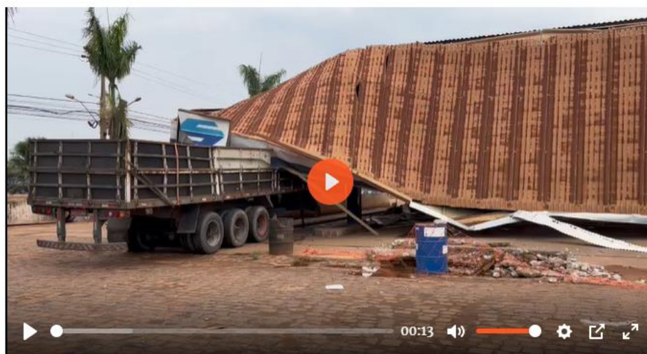
Caminhão foi atingido por queda de galpão.
