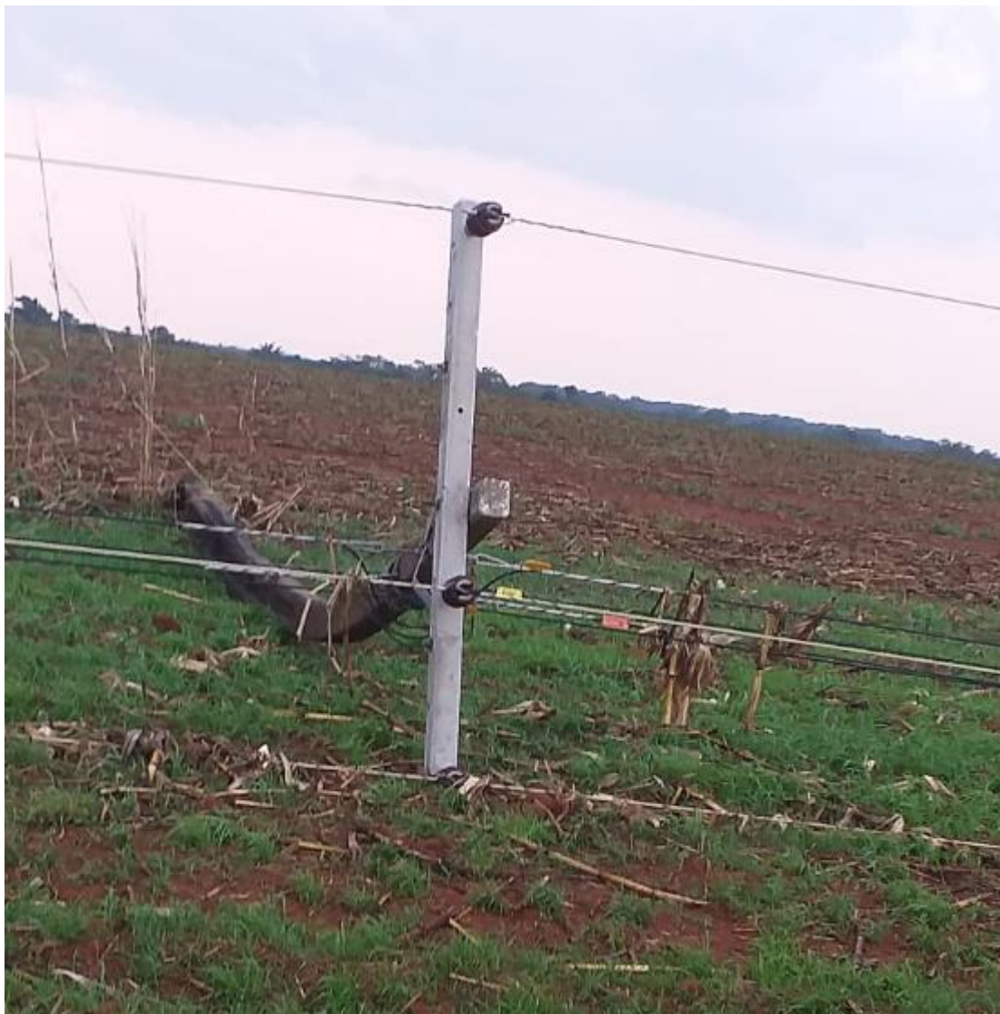
Figura 81 - Poste caído no chão em Nova Canaã do alimentador 110001. Foto tirada em 01/10/2022.
