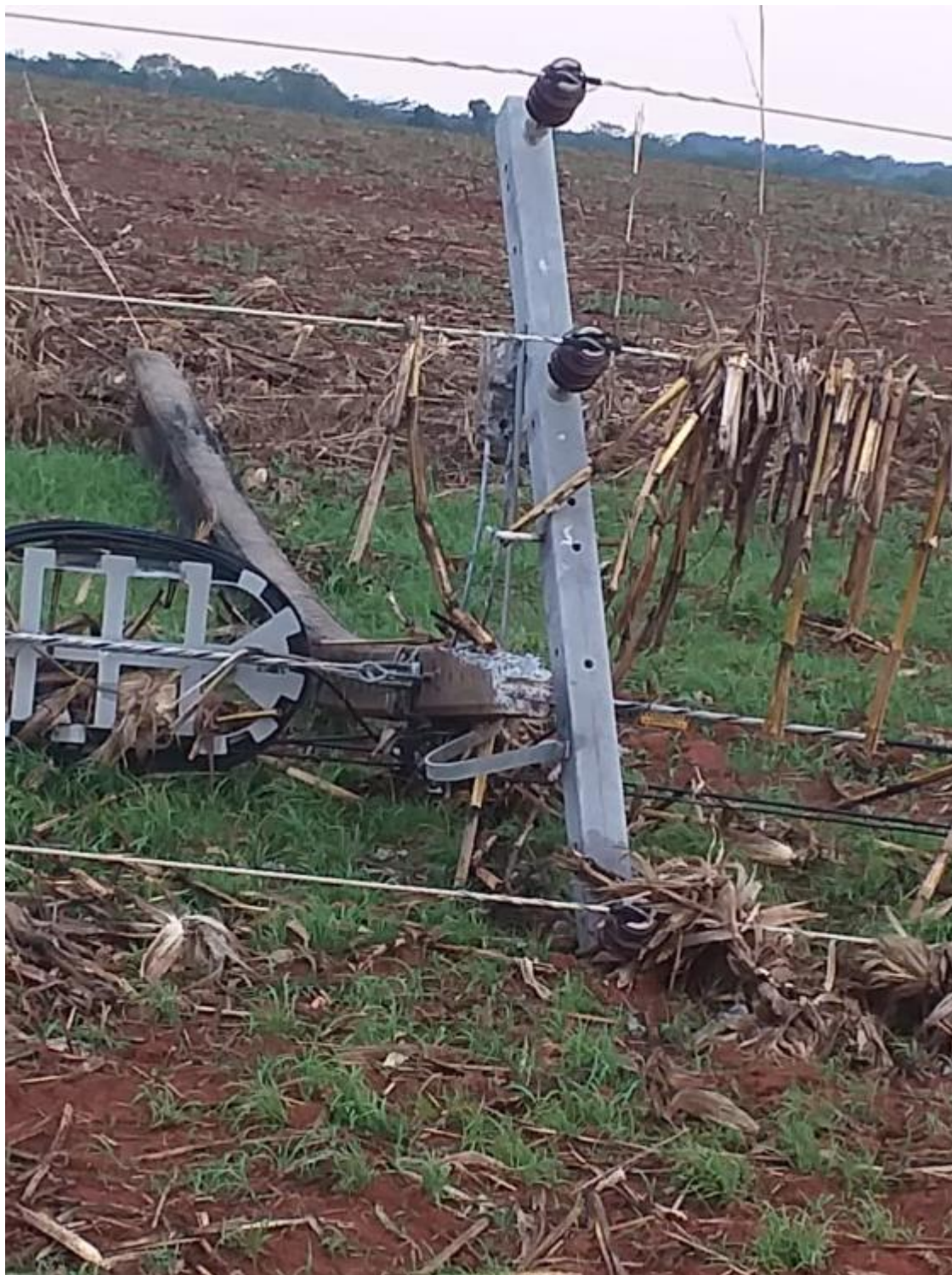
Figura 82 - Poste caído no chão em Nova Canaã do alimentador 110001. Foto tirada em 01/10/2022.
