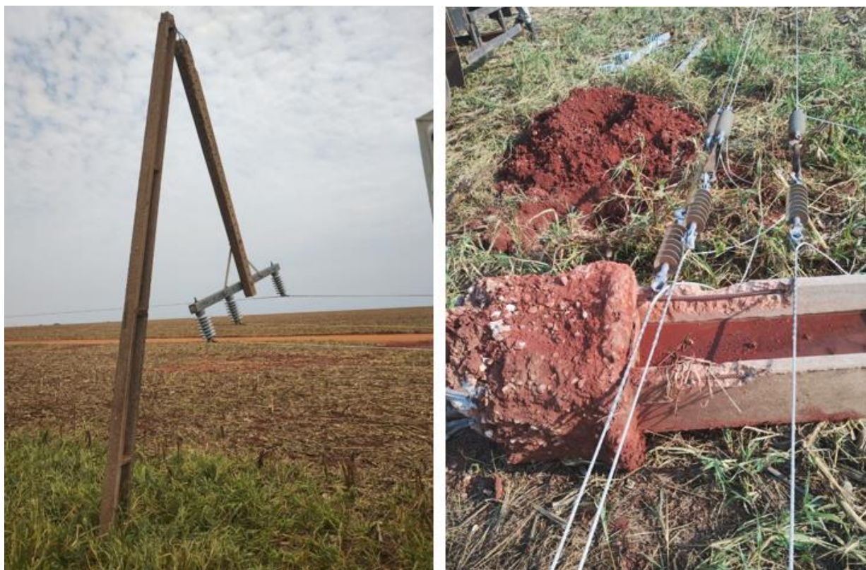
Figura 111 - Poste quebrado no município de Itiquira no dia 17/09/2023.
