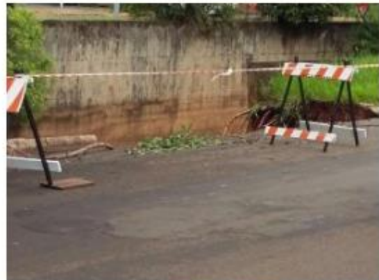
Chuva abriu cratera na Rua 26 de Agosto (Foto: Direto das Ruas)
