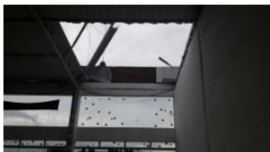
Imóvel teve parte do telhado arrancado pelo vento (Foto: Direto das Ruas)
