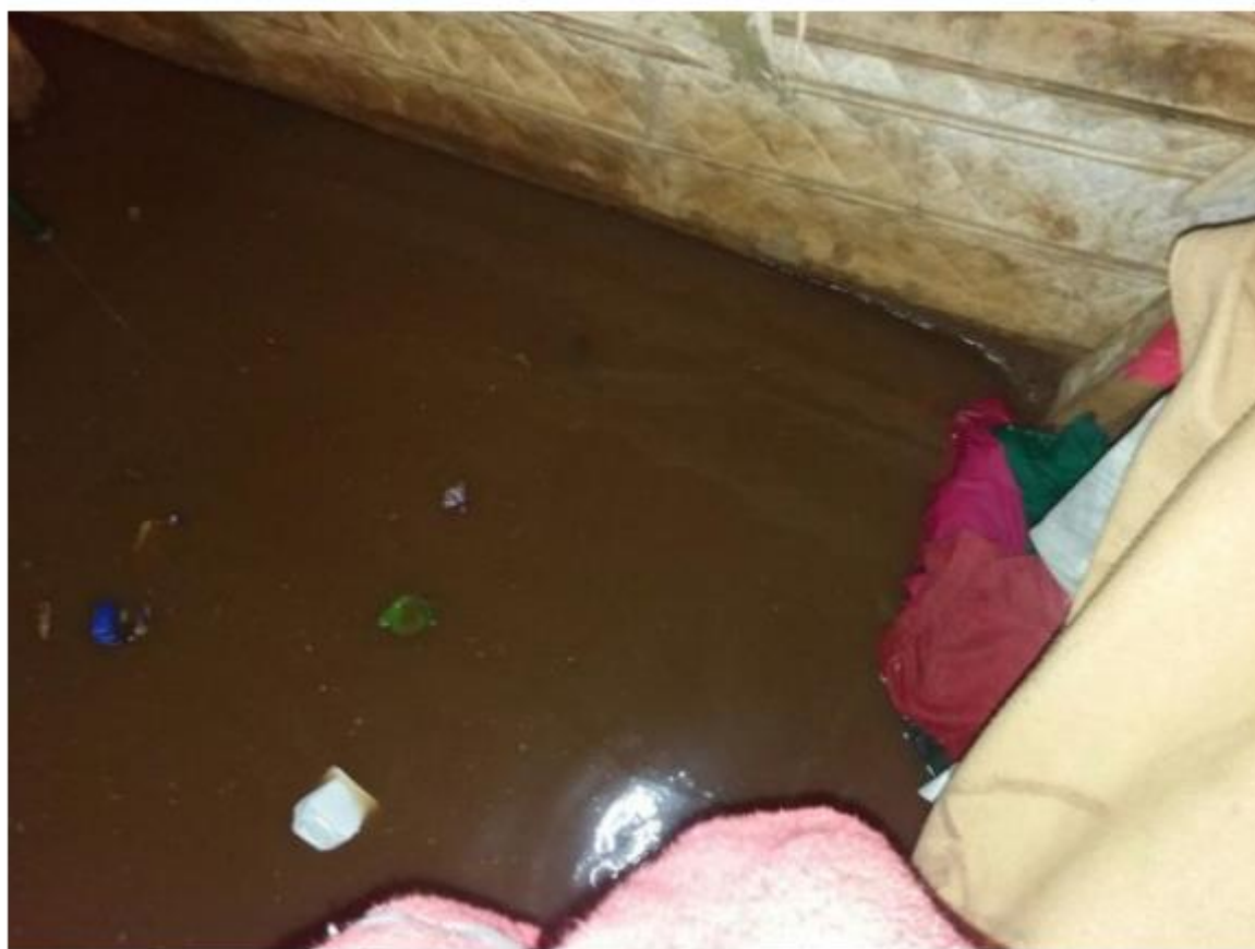
Morador do Teruel enviou foto mostrando situação de casa afetada pela chuva (Foto: Direto das Ruas)
