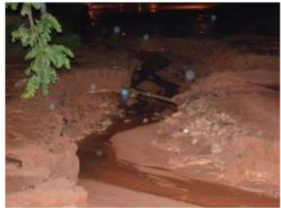
Chuva causou vários problemas, entre eles erosões e rompimento de tubulações
