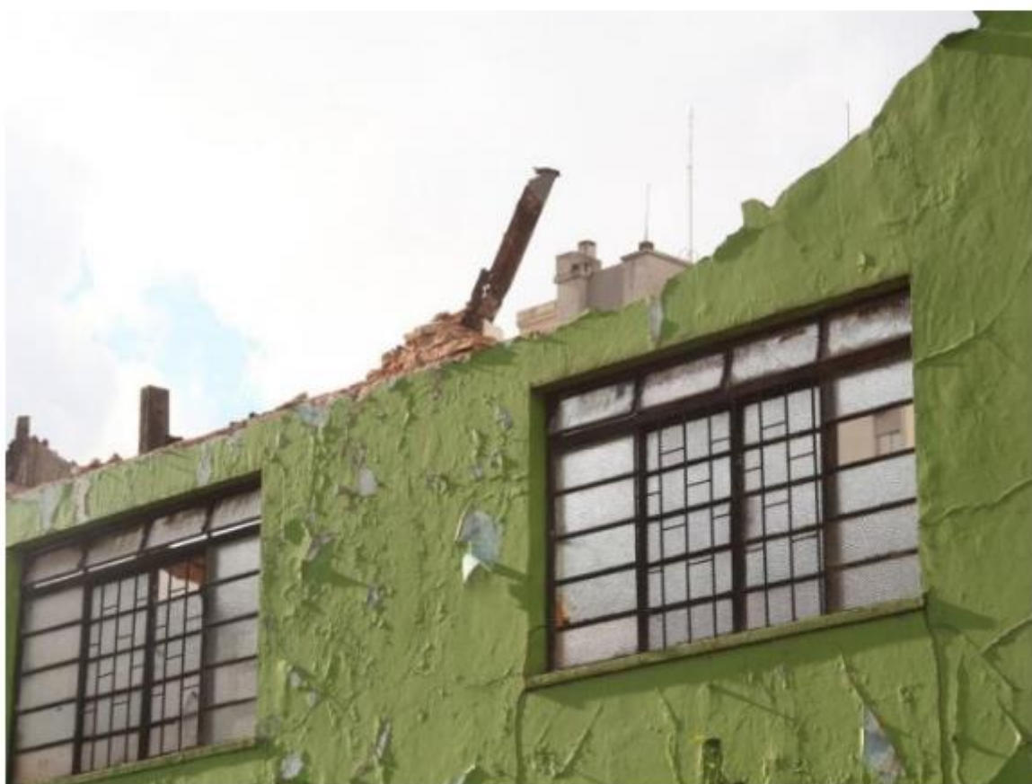
Fachada de comércio destruída após chuva neste sábado em Campo Grande. (Foto: Marcos Ermínio)
