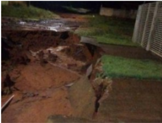
Erosão registrada ontem (27) em Ribas do Rio Pardo. (Foto: Divulgação/ Defesa Civil)
