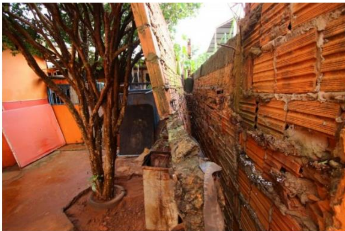
Murou cedeu e só não caiu porque ficou escorado por outra estrutura Foto: André Bittar)
