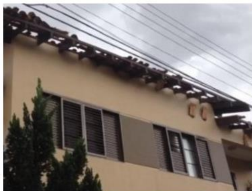
Casa destelhada no condomínio Parque das Nações Indígenas. (Foto: Direto das Ruas)
