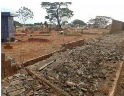
Muro do cemitério Santo Amaro, que despencou após a chuva. (Foto: Adriano Fernandes)
