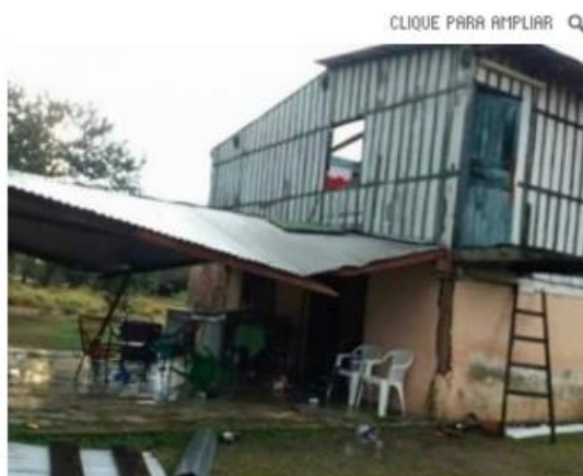
Estruturas foram afetadas principalmente no lado Paraguaio da fronteira
