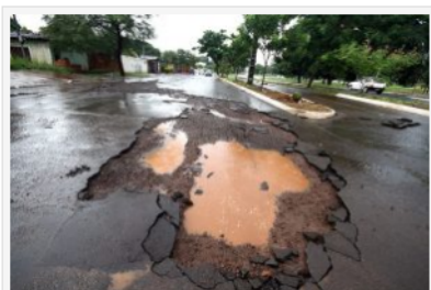
Chuva de ontem foi tão forte que buraco se abriu na rua da Divisão, no Jardim Parati; na mesma rua, em outros pontos, asfalto está esfarelando-se (Foto: Saul Schramm)
