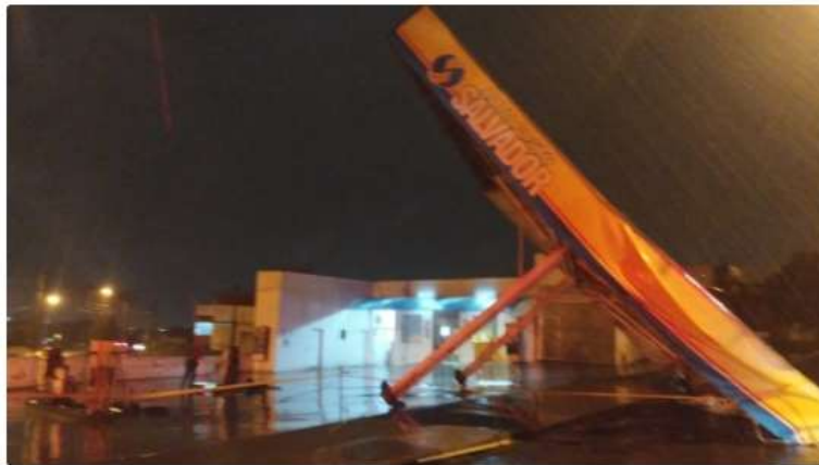
Cobertura de posto de combustíveis caiu pela força do vento em Presidente Prudente (Secom/PP).
