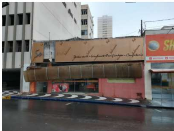
Fachada de empresa danificada pelo temporal em Prudente (Secom/PP).
