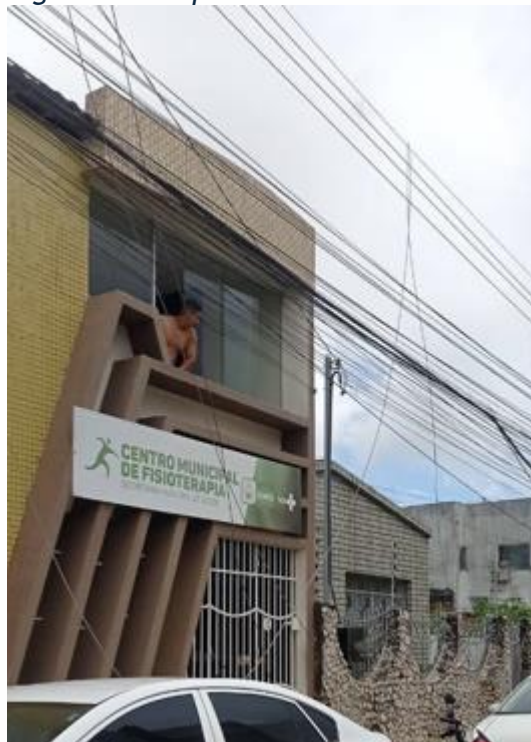
Figura: cabos partidos sobre residências
