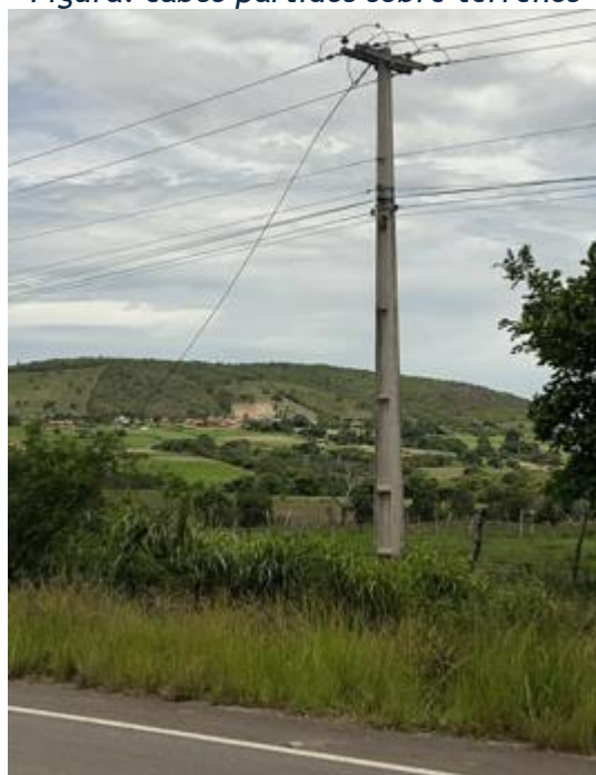
Figura: cabos partidos sobre terrenos
