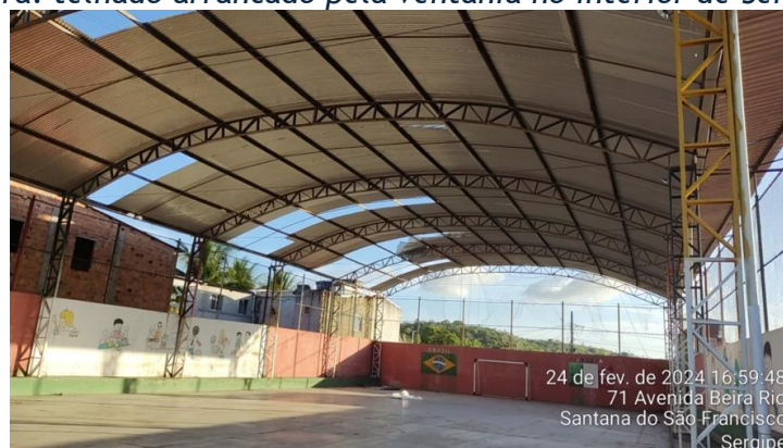
Figura: telhado arrancado pela ventania no interior de Sergipe
