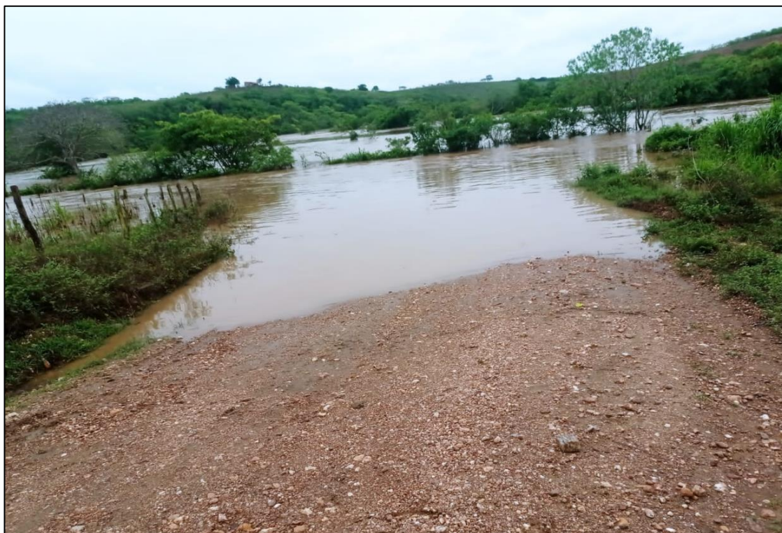
Alagamento - Estrada submersa por riacho (Fonte: Equipe Energisa)
