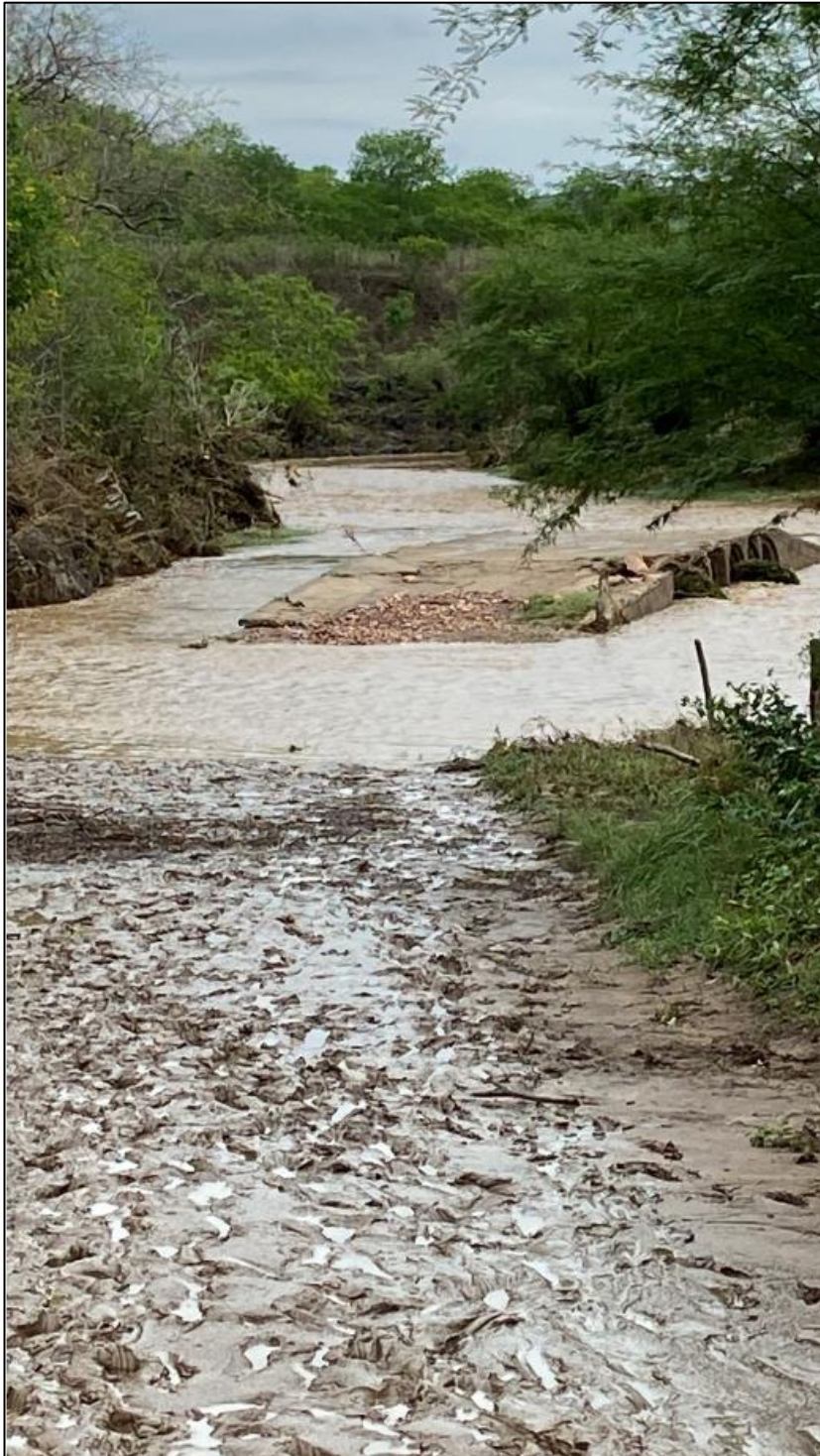
Alagamento - Estrada submersa por riacho (Fonte: Equipe Energisa)
