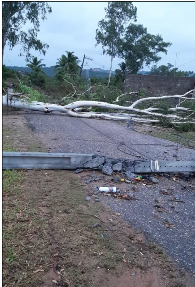
Ativos ao solo devido quedas de árvore (Fonte: Equipe Energisa)
