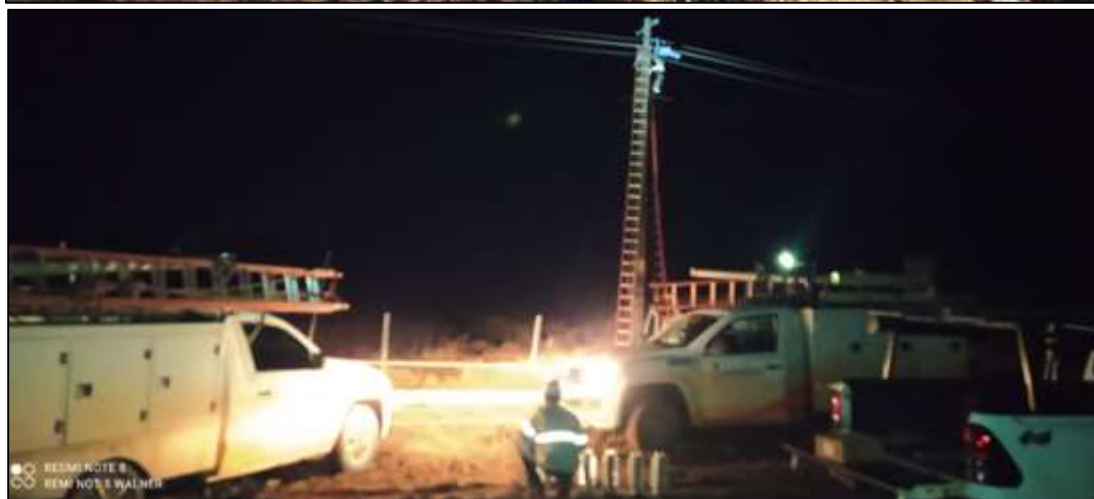
Postes quebrados, estruturas danificadas e cabo partido devido ventos fortes na região de Matupá no dia 15/09/2021.
