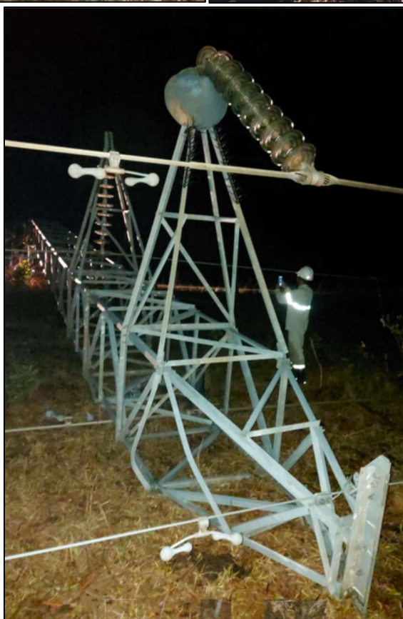
Queda de torres de transmissão e postes quebrado devidos ventos fortes na região de São Felix do Araguaia no dia 12/09/2021.
