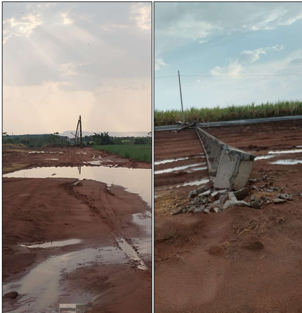
Torres e postes caídos devido ventos fortes na região de Nova Olimpia no dia 12/09/2021.
