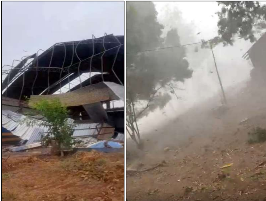
Armazém destelhado, muro derrubado e conexão rompida devido ventos fortes na região de Cáceres no dia 09/09/2021.
