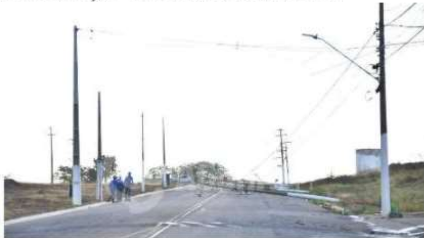
Postes caídos na Fernando Correa – Foto: Varlei Cordova/AGORAMT
