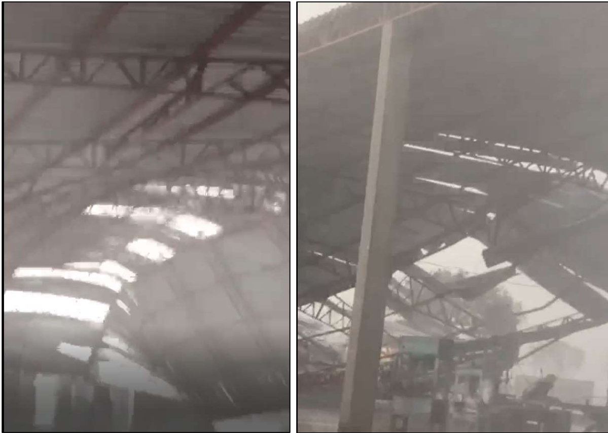
Armazém foi destelhado devido ventania e chuvas fortes na região de Juína no dia 23/09/2021.
