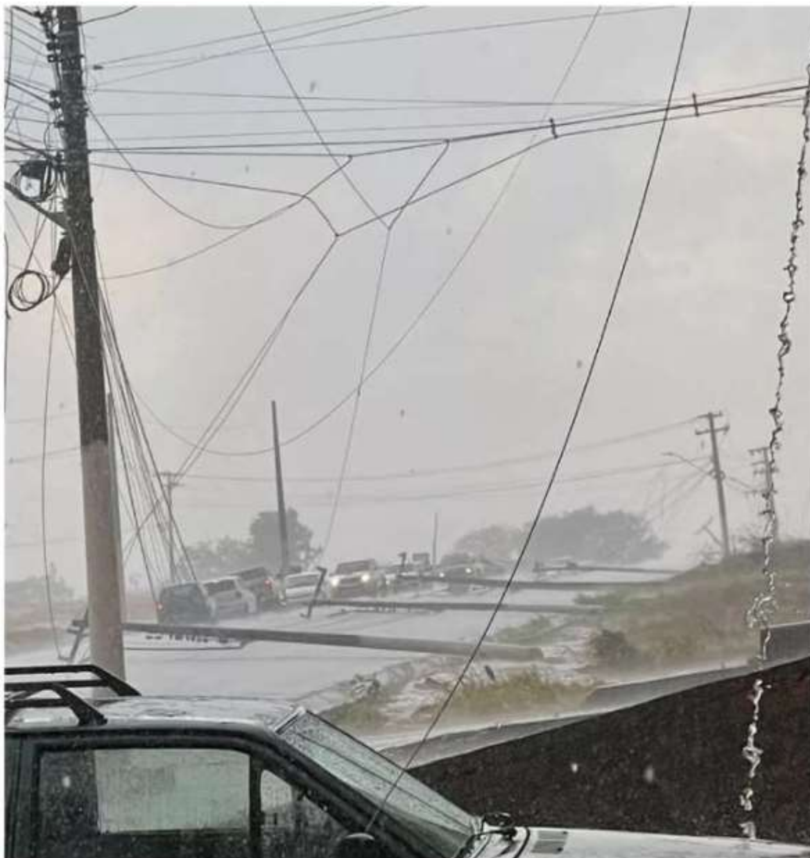
Postes caíram durante temporal em Rondonópolis (MT) — Foto: Energisa
