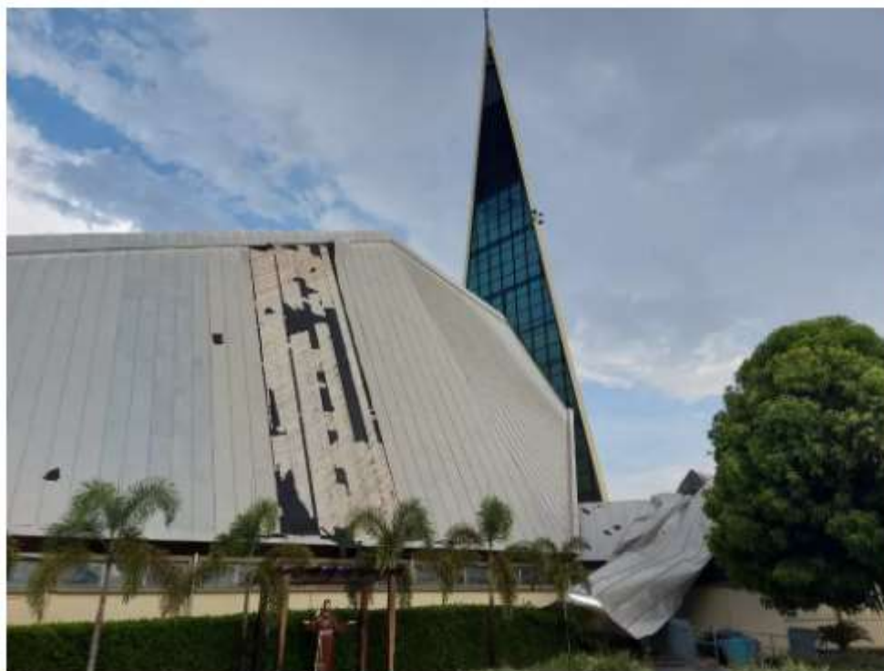
Danos provocados por forte chuva na Paróquia Nossa Senhora de Guadalupe, em Cuiabá — Foto: Ruberlei Siqueira/TVCA
