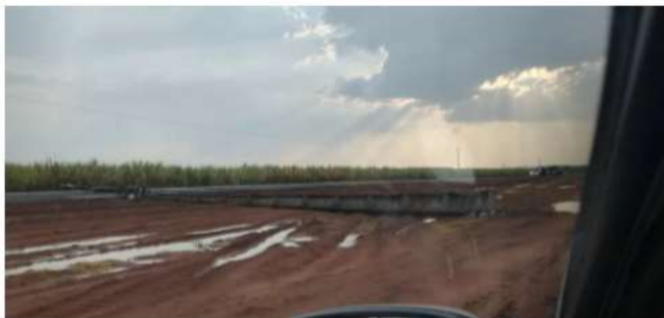
Tempestade acompanhada de ventos fortes gerou danos a uma linha de transmissão de energia ao longo da MT-343, neste domingo (12), na região do município de Denise, em Mato Grosso — Foto: Energisa
