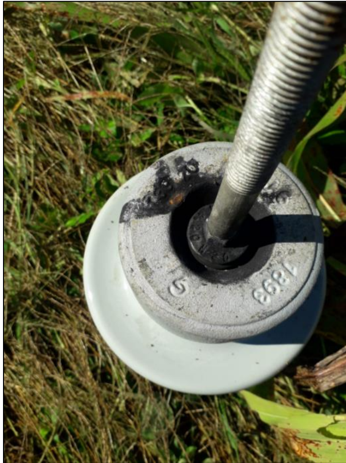
Saída do alimentador devido descarga atmosférica provocando vazamento em isolador vindo a partir cabo na região de Itanhanga no dia 14/01/2022
