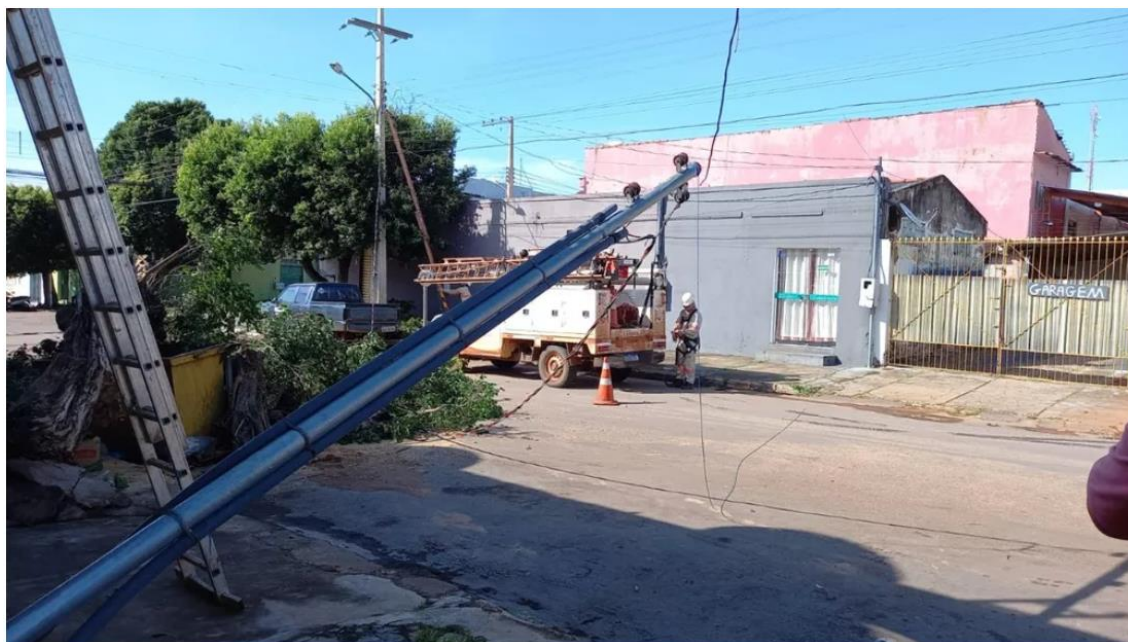
Postes de energia elétrica foram derrubados durante o vendaval — Foto: Divulgação
