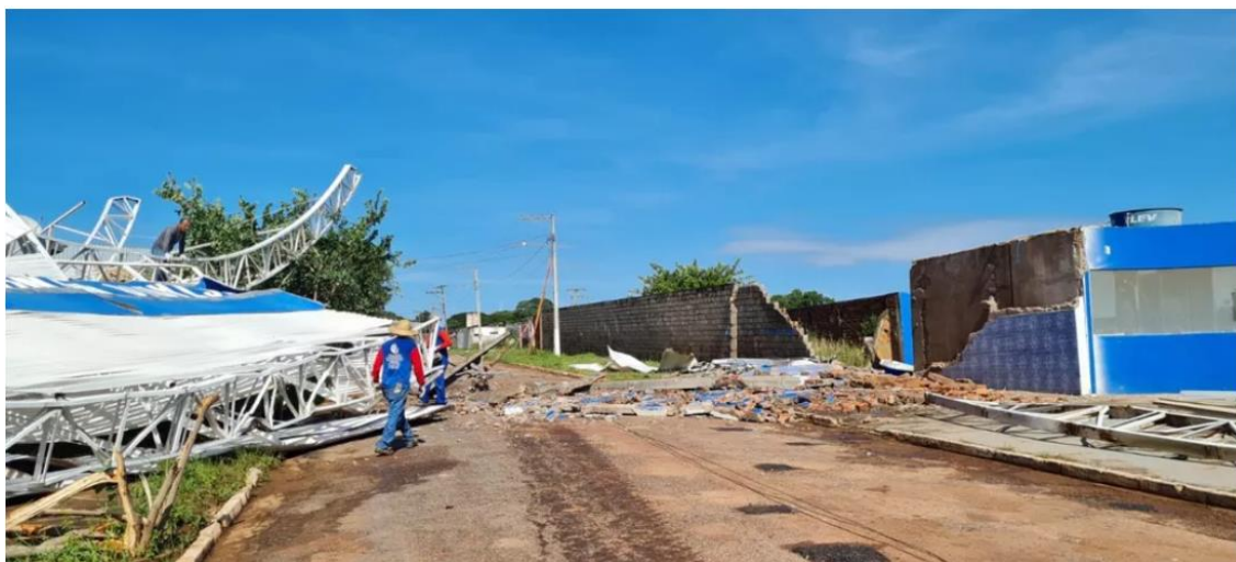
Estrutura metálica do Estádio Municipal de Jaciara (MT) desabou durante tempestade — Foto: Divulgação
