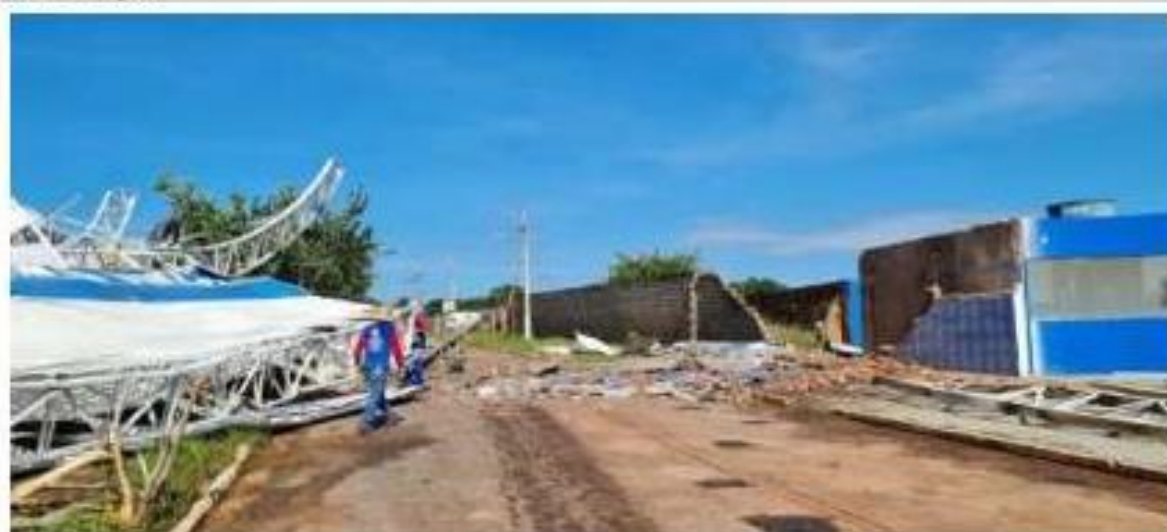
O ponto mais crítico, continua sendo o Estádio onde se perdeu toda a fachada
