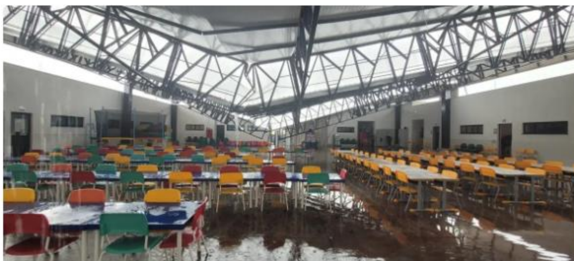
Telhado de creche caiu em Chapadão do Sul. (Foto: Divulgação)
