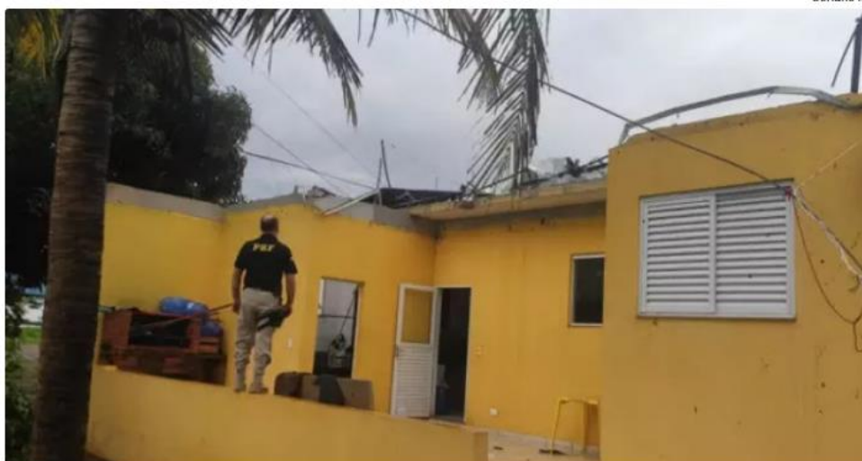
Cobertura do posto da PRF ficou destruída
