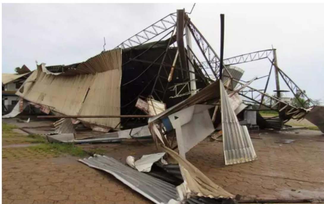
Estruturas metálicas foram danificadas pelo temporal com cerca de 80 km/h, conforme a Energisa (Foto: Cenário MS)
