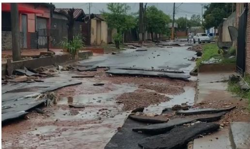
O asfalto na rua 12 de outubro, na Vila Aurea, foi arrancado. — Foto: Martim Andrada/TV Morena
