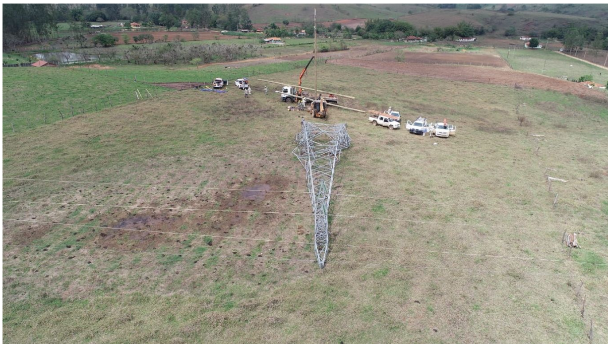
Foto registrada por colaborador da Energisa, estrutura da LDAT 138 kV VRB2/VOT. 05/10/2022.
