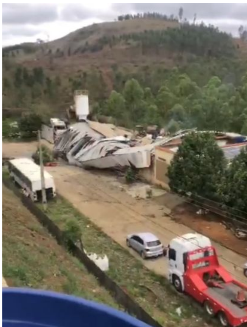
Guamuriaé. Destruição no Distrito Industrial em Muriaé. Muriaé, 05/10/2022. Instagram @Guia Muriaé. Disponível em https://www.instagram.com/reel/CjVcE2av6VF/?igshid=YmMyMTA2M2Y= . Acesso em: 05/10/2022.
