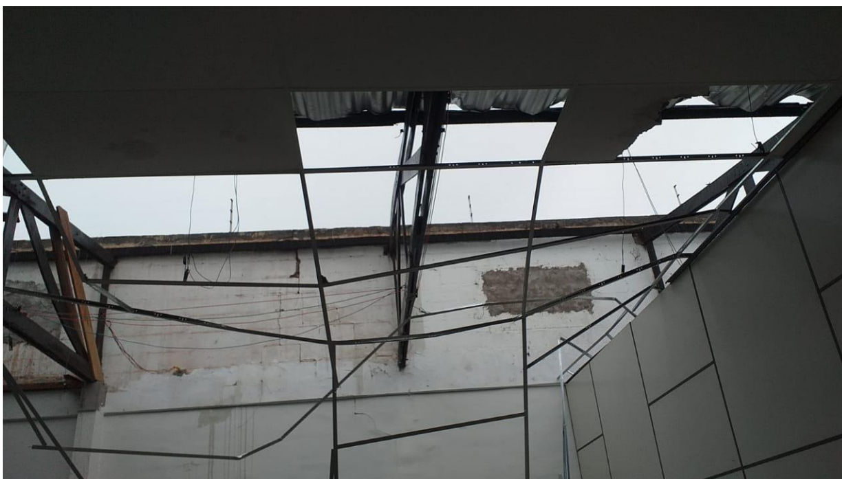
Figura 103 - Estrago causado no prédio da Dínamo em Rondonópolis-MT. Foto tirada dia 19/08/2022
