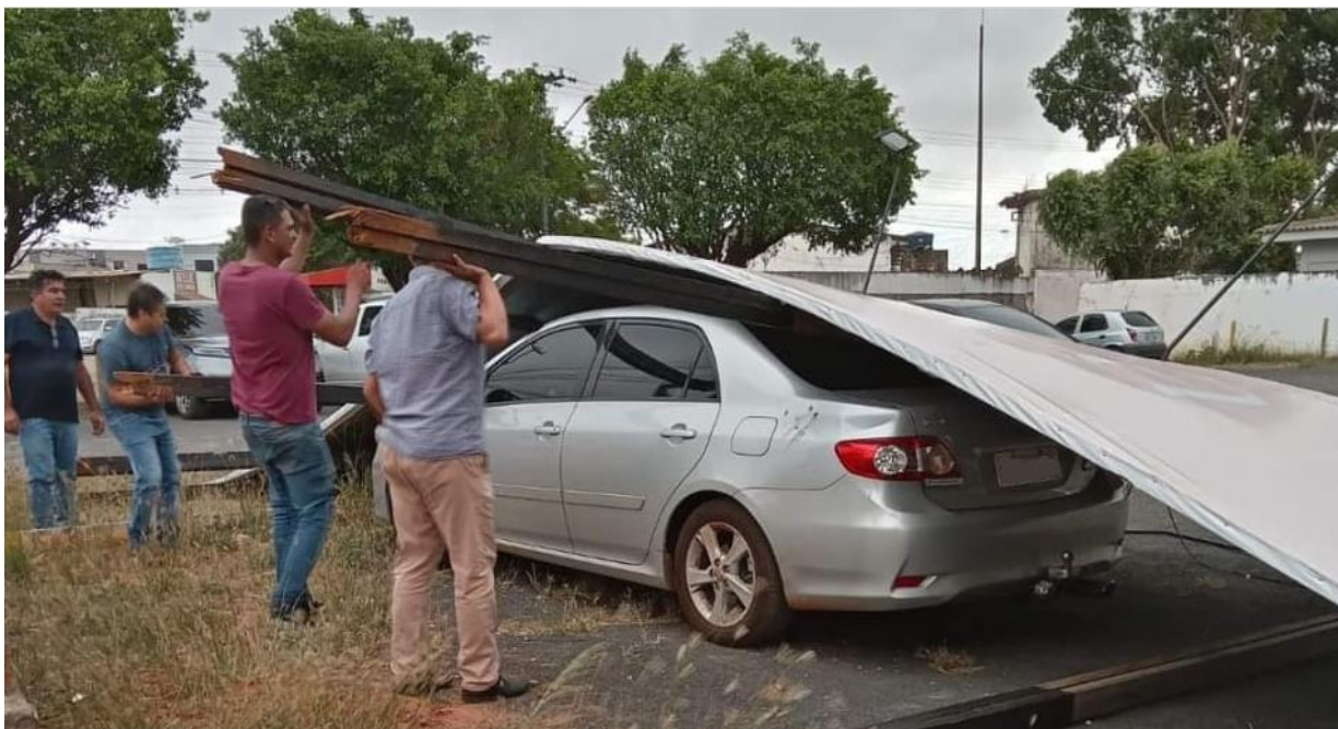
Figura 102 - Estrutura caída sobre carro em Campo Novo - MT. Foto tirada dia 19/08/2022
