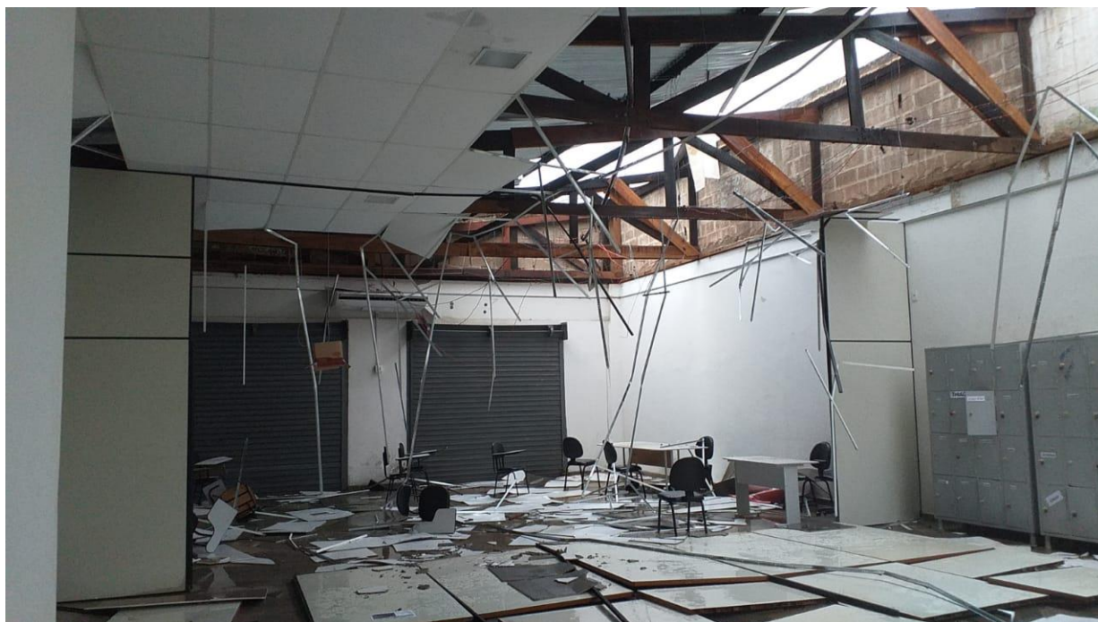
Figura 104 - Estrago causado no prédio da Dínamo em Rondonópolis-MT. Foto tirada dia 19/08/2022
