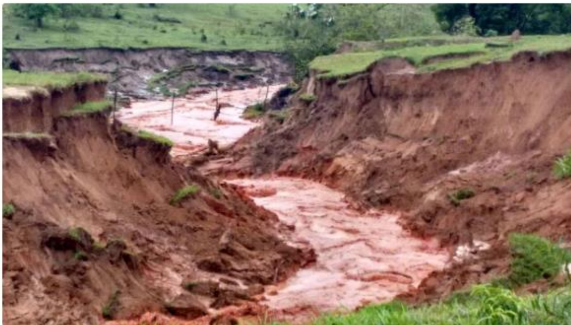
☐ Forte chuva dos últimos dias deixou estragos e causou transtornos aos moradores da zona rural de Novo Horizonte do Sul, MS (Foto: Prefeitura de Novo Horizonte do Sul/Divulgação)
