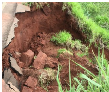
Erosão começou no bordo da via - Divulgação / PRE
