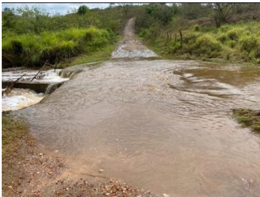
Alagamento - Estrada submersa por riacho (Fonte: Equipe Energisa)
