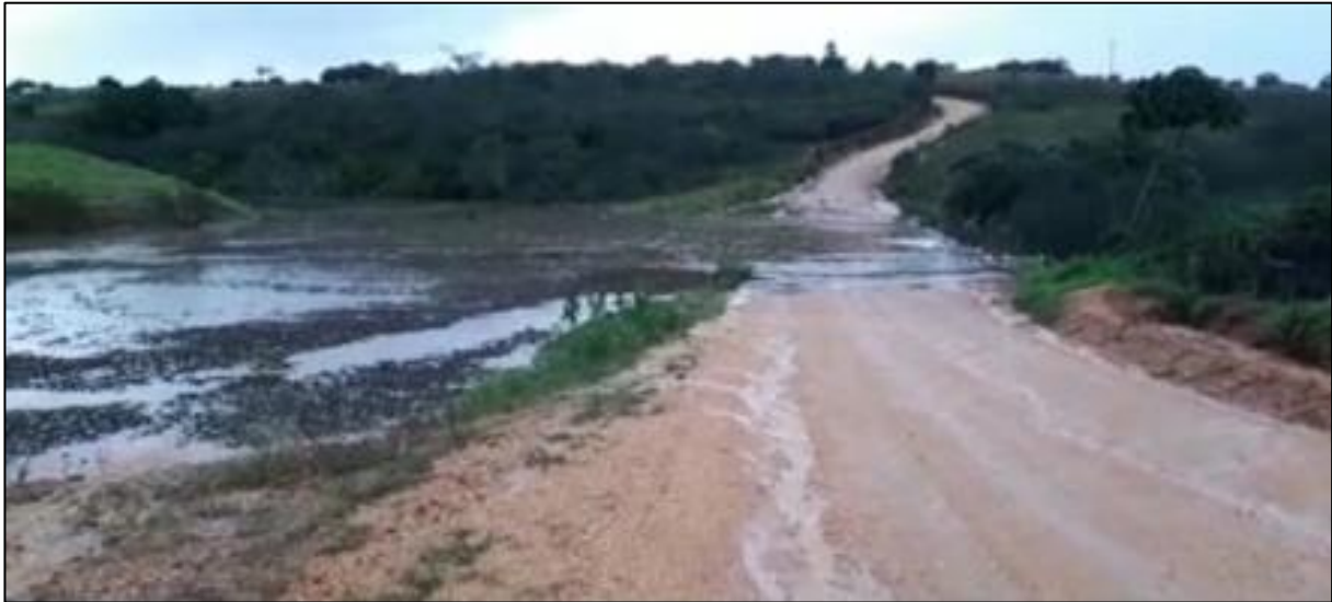
Alagamento - Estrada submersa por riacho (Fonte: Equipe Energisa)
