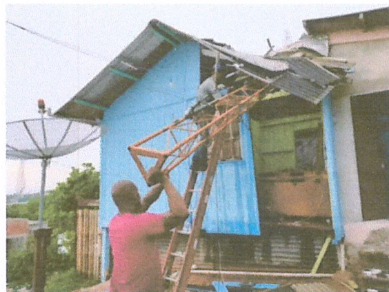
Torre cai sobre casa durante temporal em Cruzeiro do Sul — Foto: Gedisson Albeni/Rede Amazônia Acre
