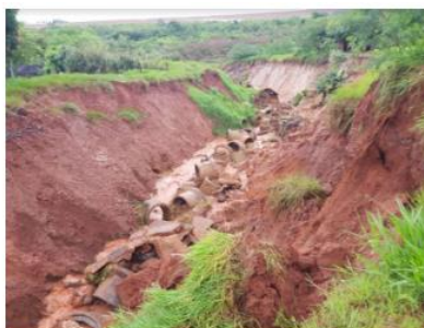
Erosão avança e põe em risco moradias foto - A GazetaneWS
