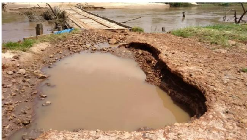
Cabeceira de ponte comprometida pelos temporais desta semana em Amambai, no sul de MS — Foto: Defesa Civil de Amambai/Divulgação
