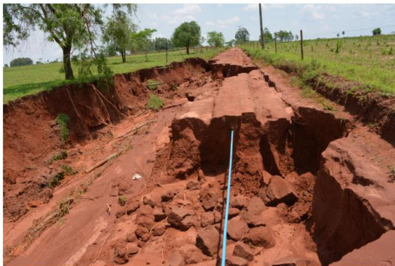
Estrada do P.A. Santo Antônio. Enxurradas levaram árvores, cercas e parte da pista de rolamento deixando o trecho intrafegável. Foto: Roney Minella
