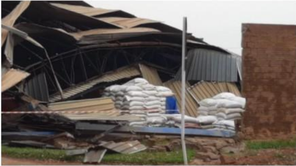
Estrutura metálica desabou em Ji-Paraná — Foto: Junior Caju/Rede Amazônica
