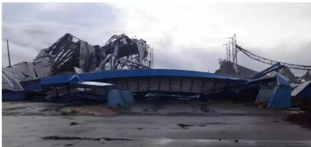
Cobertura do Parque de Exposições de Laguna Carapã (MS) desabou após fortes chuvas no estado — Foto: Laguna News
