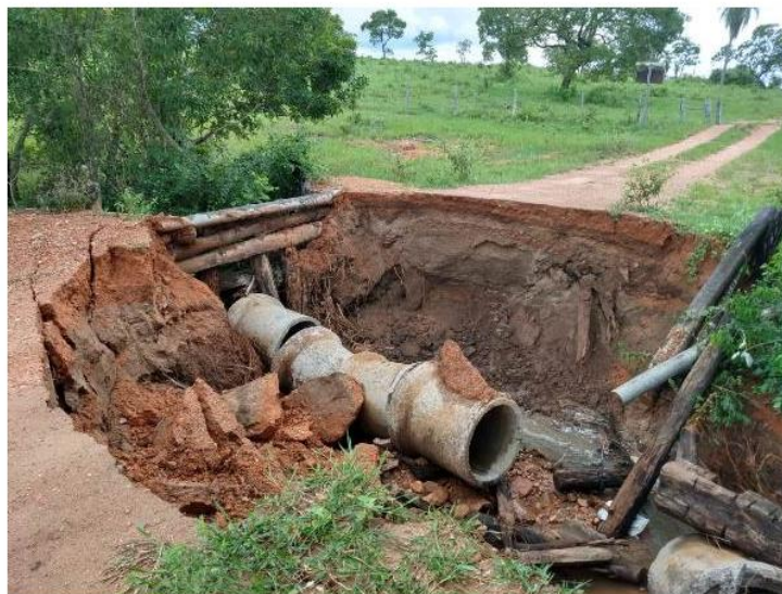
Estrada rural ficou totalmente destruída
