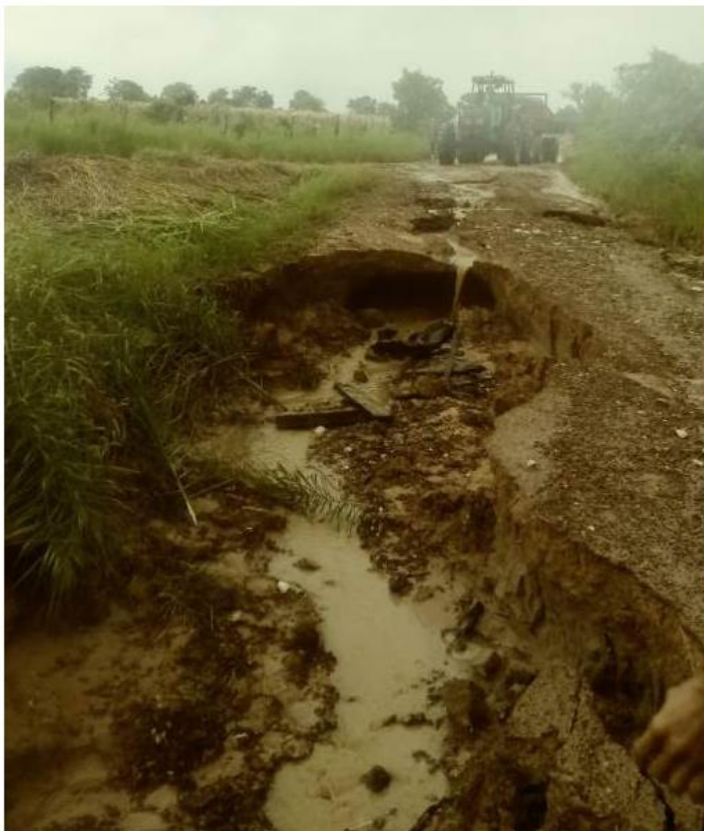
Crateras se formaram nas estradas do município
