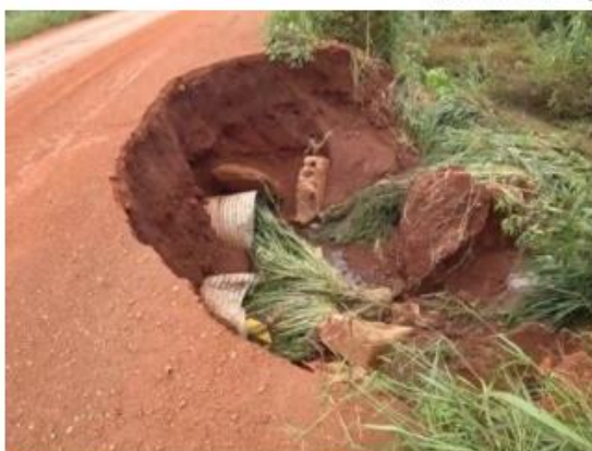
Erosão se formou após chuvas de ontem, 15 de março. (Foto: Reprodução/Defesa Civil/Maracaju)
