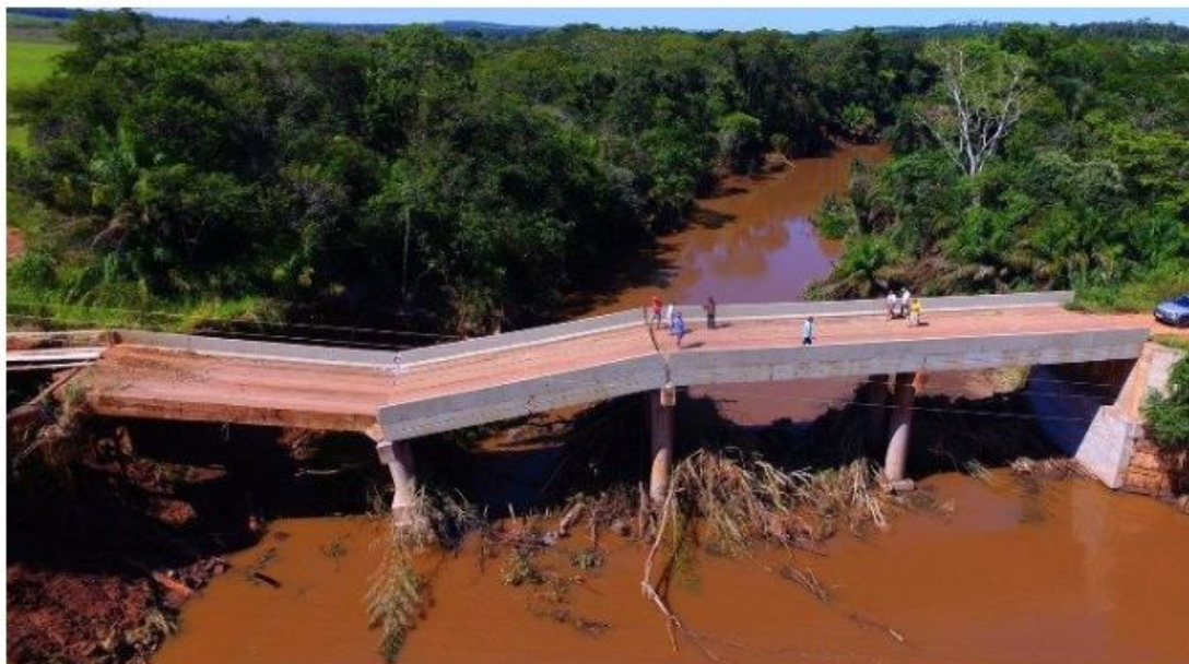
Ponte sobre Rio dos Velhos, em Jardim (MS), desabou parcialmente no dia 19 de fevereiro - Foto: Chico Ribeiro/Segov
