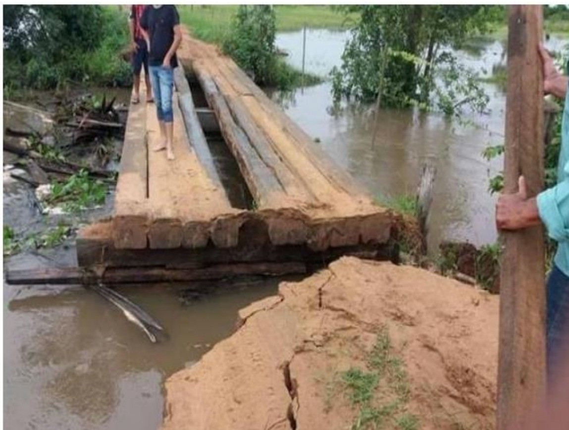
Ponte em estrada vicinal de Rio Verde sofreu danos após chuva (Fonte: Prefeitura de Rio Verde)
