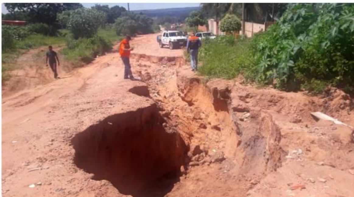
Voçoroca que se abriu em rua de Coxim (MS) depois das fortes chuvas (Foto: Defesa Civil de MS/Divulgação)
