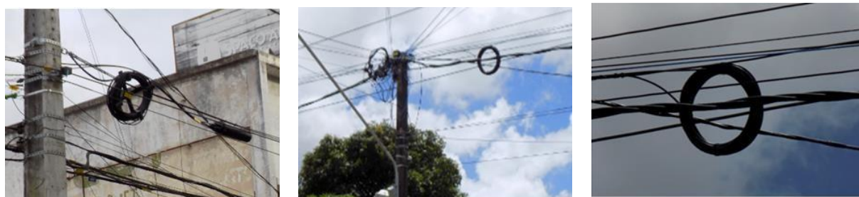
Figura 05. Instalações irregulares de reversas técnicas tipo cruzeta.
