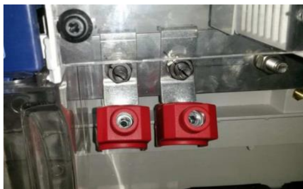
Foto 2 - Conectores com Proteção
